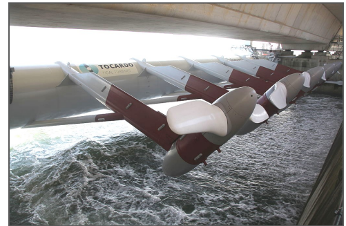
Turbinerna på ett tidvattenkraftverk i Nederländerna
